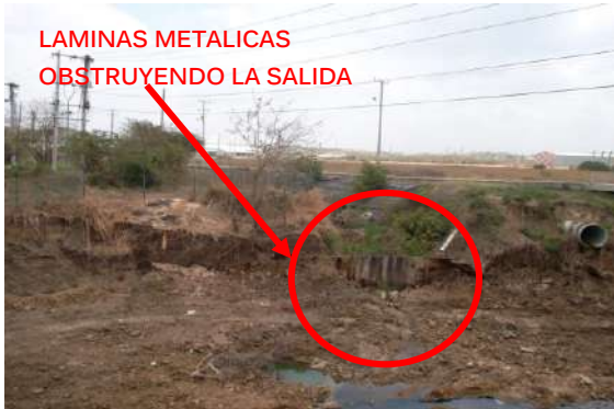
FOTO No 3 DRENAJE PLUVIAL OBSTRUIDO CON LAMINAS METALICAS.
