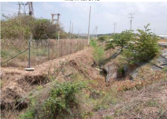
FOTO No 4 DRENAJE PLUVIAL OBSTRUIDO CON LAMINAS METALICAS
