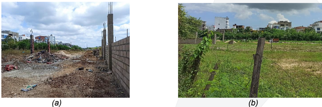
Figura 8. Estado de la estructura aporticada observada: a) visita 3 de Marzo de 2022; b) visita 29 de Junio de 2022
