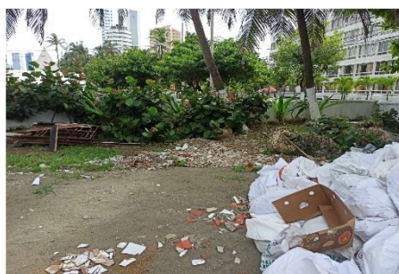
Punto de acopio de RCD, se observan piezas de baldosas.
