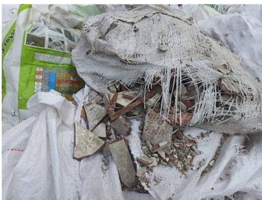
Contenido interno de las bolsas de RCD acopiadas, se observan piezas de baldosas
