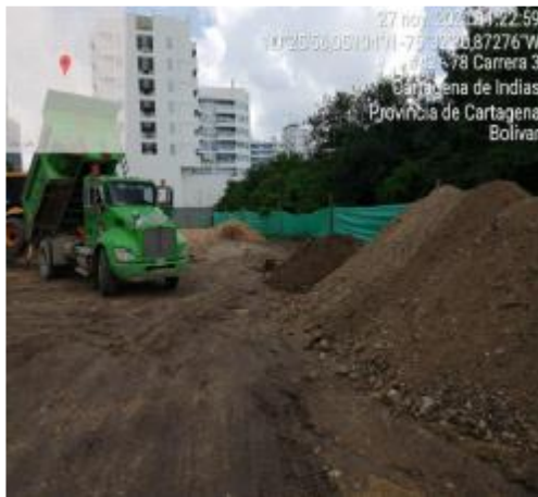
Imagen 2. Desarrollo de la visita, se evidencia RCD tipo excavación.
