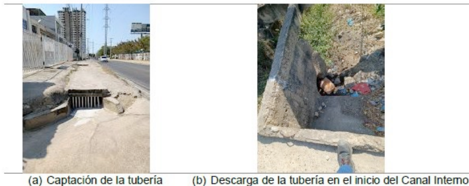
Figura 4. Tubería de 23" detectada por UT-VISCAR
