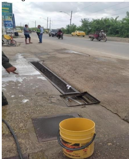
Imagen 6. Retención de Lodos.
