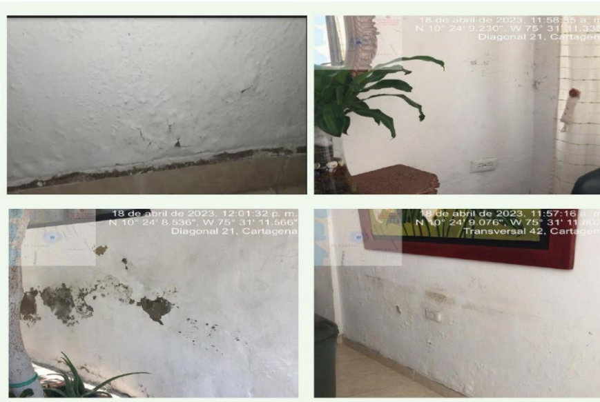
Figura 1. Humedad en paredes de vivienda afectada.
