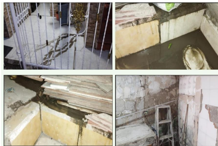
Figura 2. Filtración de ARnD y Reparaciones en vivienda afectada
