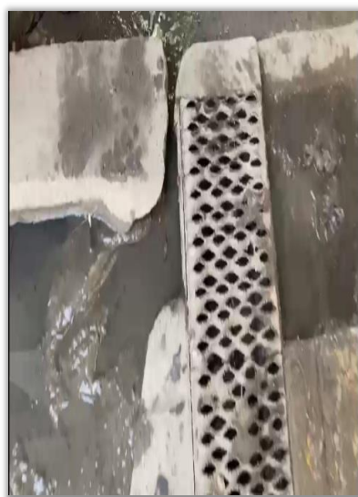
LODOS ACUMULADOS DE AGUA ESTANCADA
