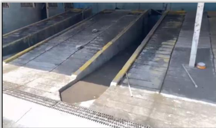
ZONA DE LAVADO DE CARROS LAVADERO CAR WASH
