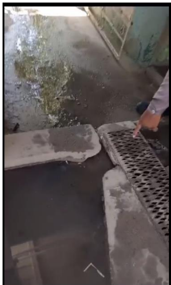
AGUA ESTANCADA EN LA REJILLA
