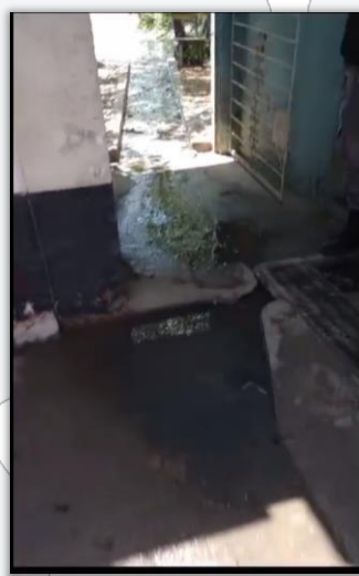
AGUAS SALIENDO HACIAS LA LAGUNA SAN LÁZARO
