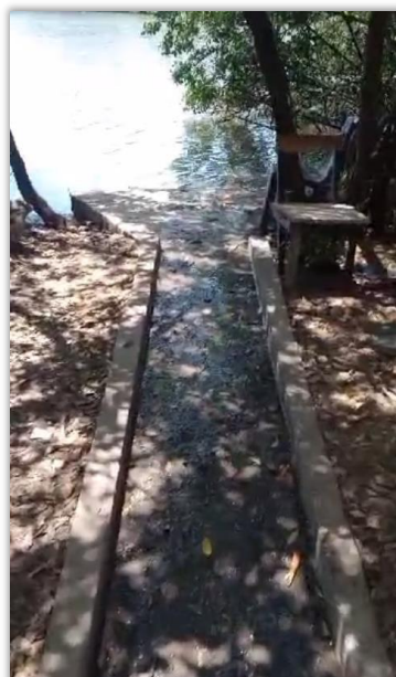
CANAL CONDUCCION DE AGUAS
