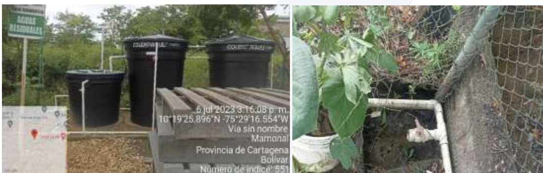
Ilustración 3. Tanques de pre tratamiento de ARnD.
