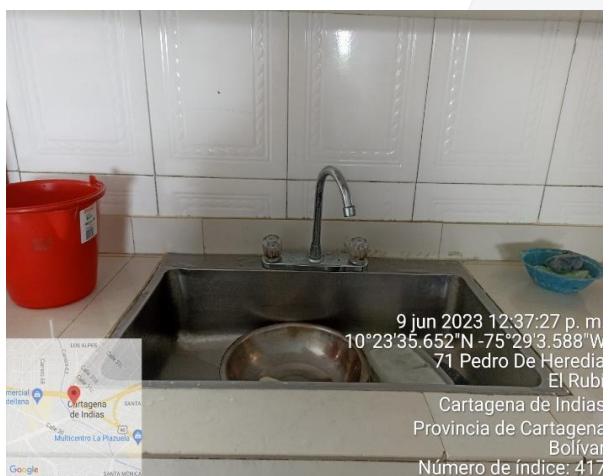
Imagen 2. Vertimiento proveniente del lavado de utensilios de cocina
