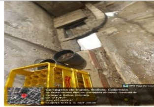
Imagen 4. Primer registro donde se ubica la trampa de grasa
