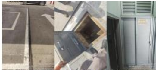
Figura 4. (a) Rejillas perimetrales. (b) Sistema de trampas de grasas y sedimentadores. (c) Zona de almacenamiento de RES/PL. EDS LA SAN MARTIN Fuente: Propia
