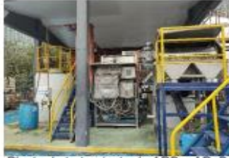
Planta de tratamiento de ARD y ARnD.
