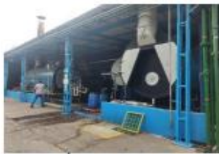
Área de calderas.
