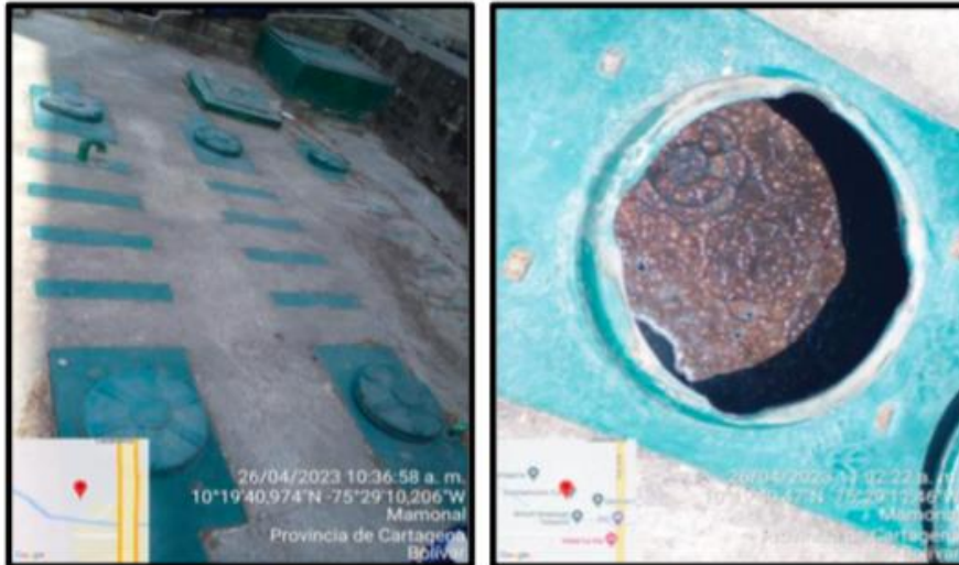
Imagen 2. y 3. Sistema de tratamiento ARD-Filtro anaerobio
