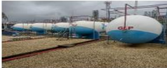
Tanques de almacenamiento GLP
