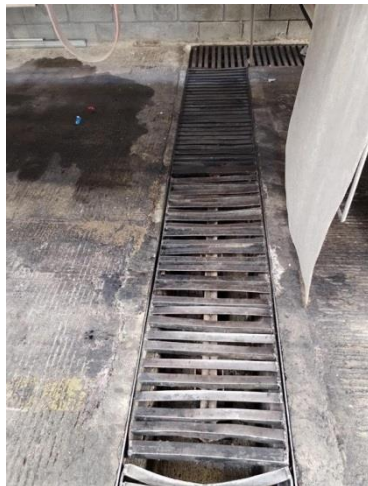
Canales perimetrales internos
