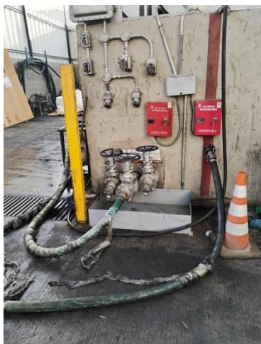
Zona de válvulas tanques 7, 8, 9
