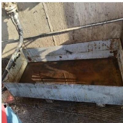
Zona de válvulas tanques 1 al 6
