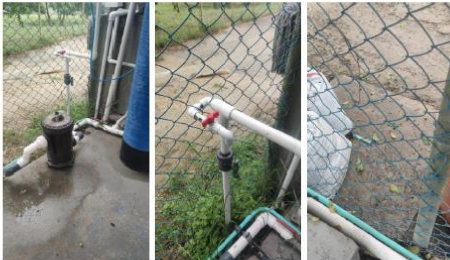
Ilustración 3. Punto de unificación de aguas para su vertimientos final
