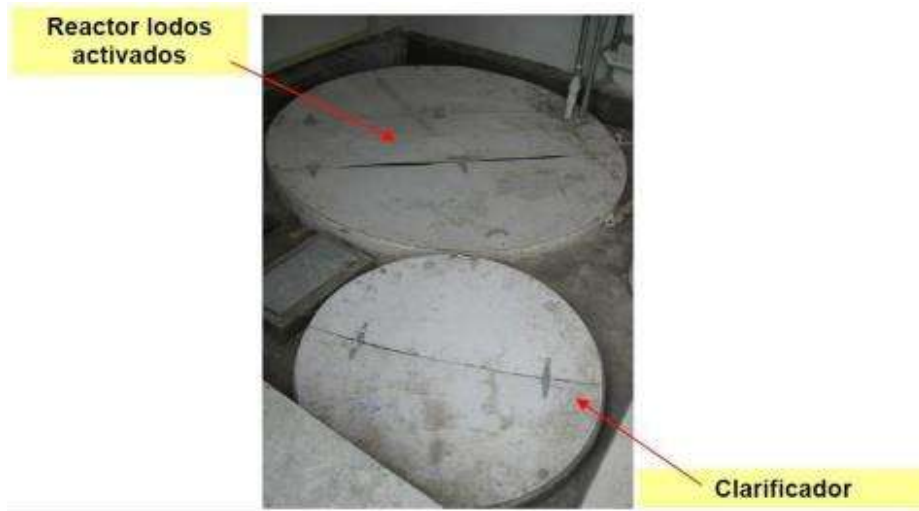
Ilustración 7. Reactor de lodos activados y Clarificador
