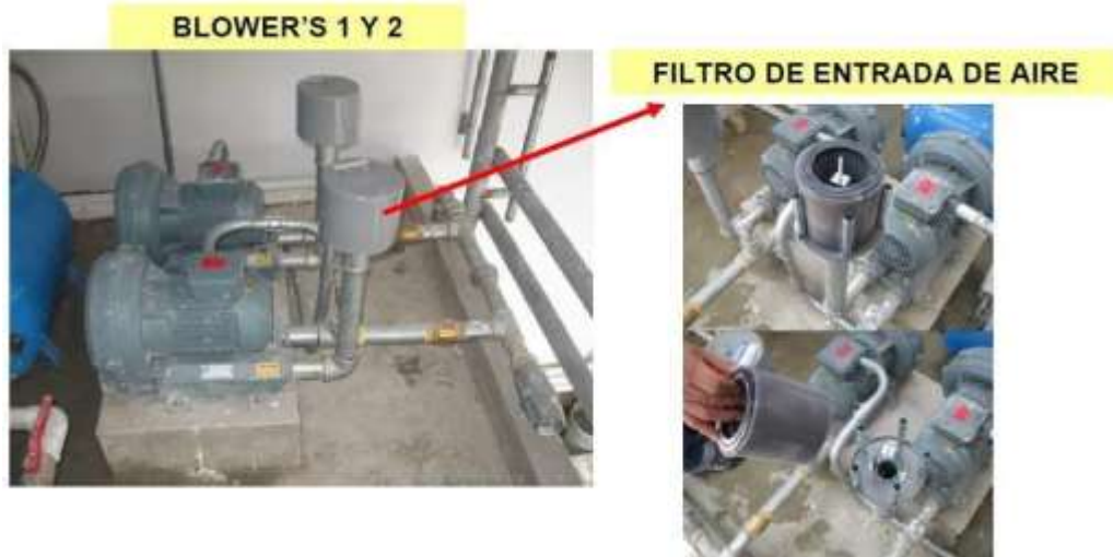
Ilustración 8. Sistema de aireación
