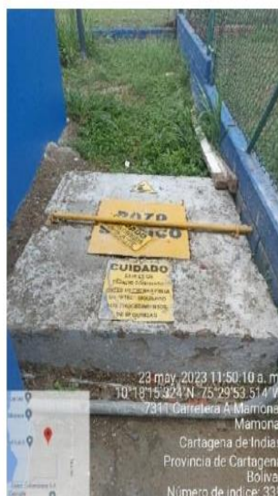
Imagen 9. Pozo séptico Garita
