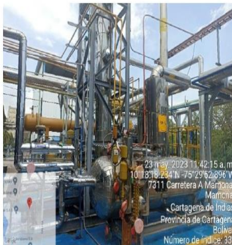
Imagen 4. Paso del gas antes de llegar a la torre de enfriamiento
