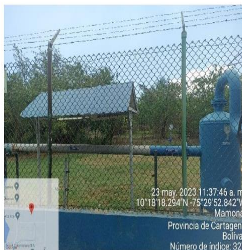
Imagen 2. Gasoducto proveniente de Yara
