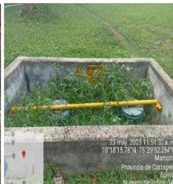
Imagen 8. Poza Séptica zona administrativa
