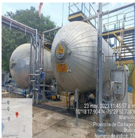
Imagen 6. Tanques de almacenamiento de CO 2
