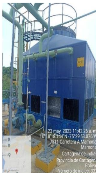
Imagen 5. Torre de enfriamiento
