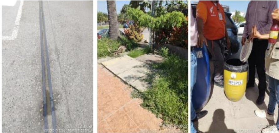
Figura 4. (a) Rejillas perimetrales. (b) Sistema de trampas de grasas y sedimentadores. (c) Zona de almacenamiento de RESPEL - EDS MAMONAL
