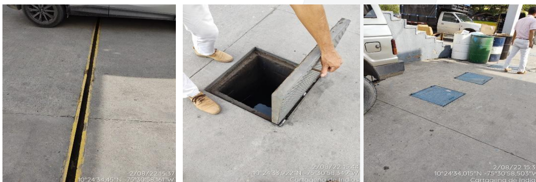
Figura 4. (a) Rejillas perimetrales. (b y c) Sistema de trampas de grasas y sedimentadores- EDS AUTOBOL. Fuente: Propia
