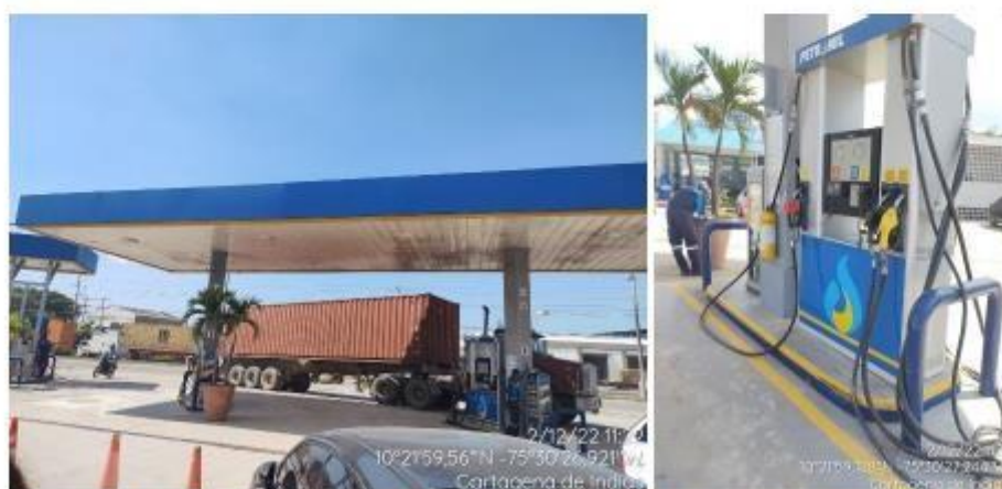
Figura 3. Islas y Surtidores de distribución de combustibles - EDS VICPIMAR
