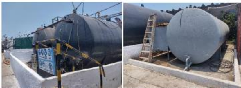
Tanques de almacenamiento de aceites de las aguas aceitosas tratadas.
