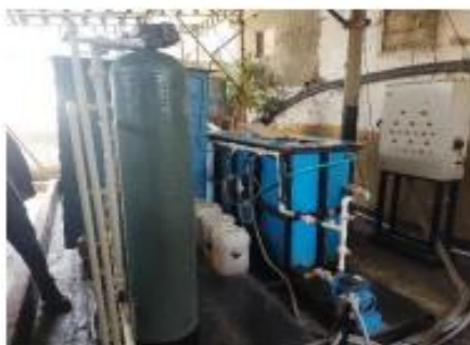
Planta de tratamiento de las aguas aceitosas.
