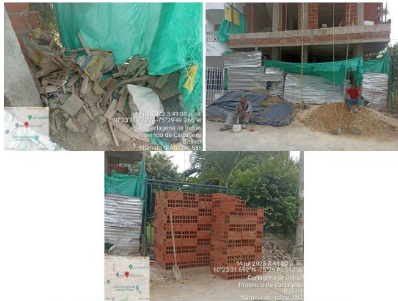
Imagen 1. Inadecuado manejo RCD, contaminación por material particulado
