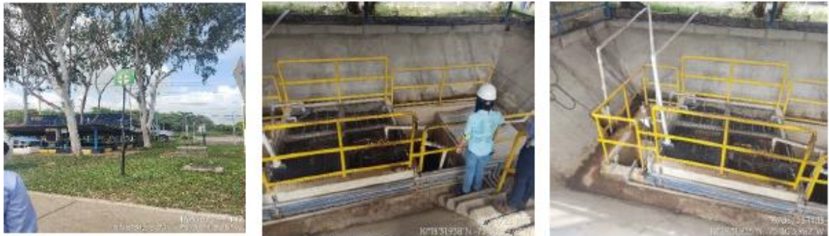
Planta de Tratamiento ARnD
