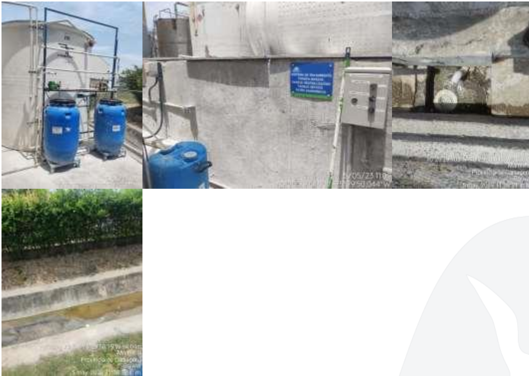
Figura 2. Composición Sistema de Tratamiento de Aguas Residuales (PTAR)
