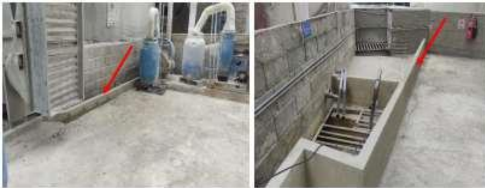
Figura 5. Extensión del dique de contención. Fuente: NUTRESOL, 2023
