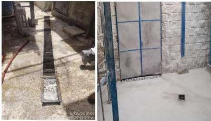
acopio aguas residuales.
