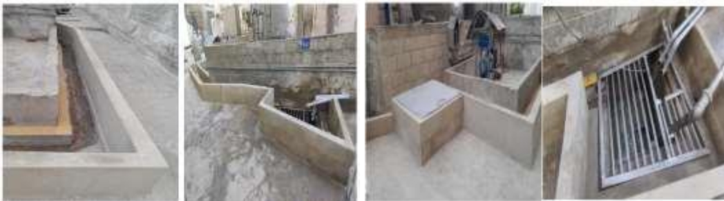
Construcción de muro o dique de contención en perímetro de canalización y registro de aguas residuales
