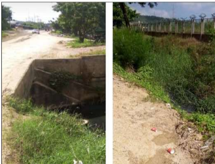
Imagen 11. Canal localizado en costado derecho de la vía. Fuente: Elaboración propia (SID 2021).
