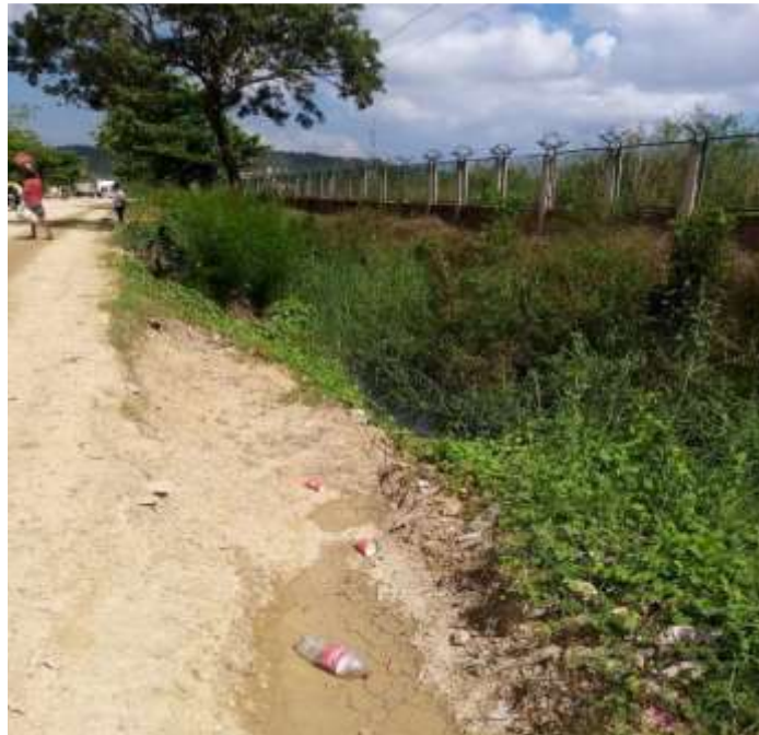
Imagen 10. Canal localizado en costado derecho de la vía. Fuente: Elaboración propia (SID 2021).
