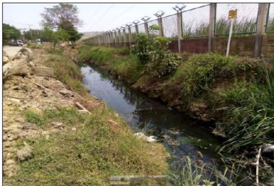
Imagen 7. Canal localizado en costado derecho de la vía. Fuente: Elaboración propia (SID 2021).
