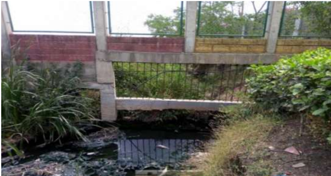
Imagen 8. Canal localizado en costado derecho de la vía. Fuente: Elaboración propia (SID 2021).
