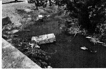
Ilustración 6. Presencia de residuos sólidos en el canal. Fuente de foto: funcionario EPA.
