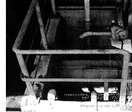
Tanque de retención de lodo y agua clarificada
