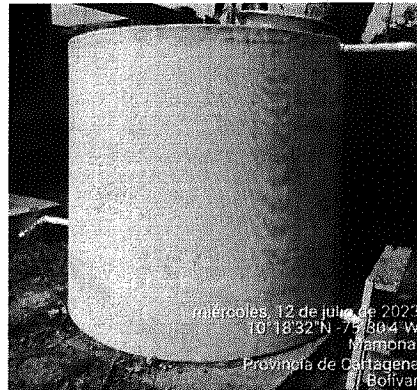
Tanque de agua clarificada
