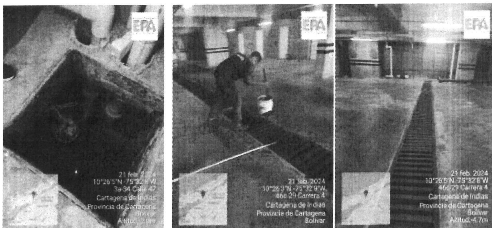
Imagen 1. Punto de Registro de Aguas de nivel freático y rejillas de recolección
