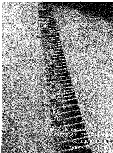
Ilustración 3. Retención de Lodos y residuos sólidos en las rejillas
