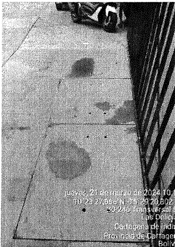
Ilustración 3. Sistema de tratamiento existente Trampa de Grasas
