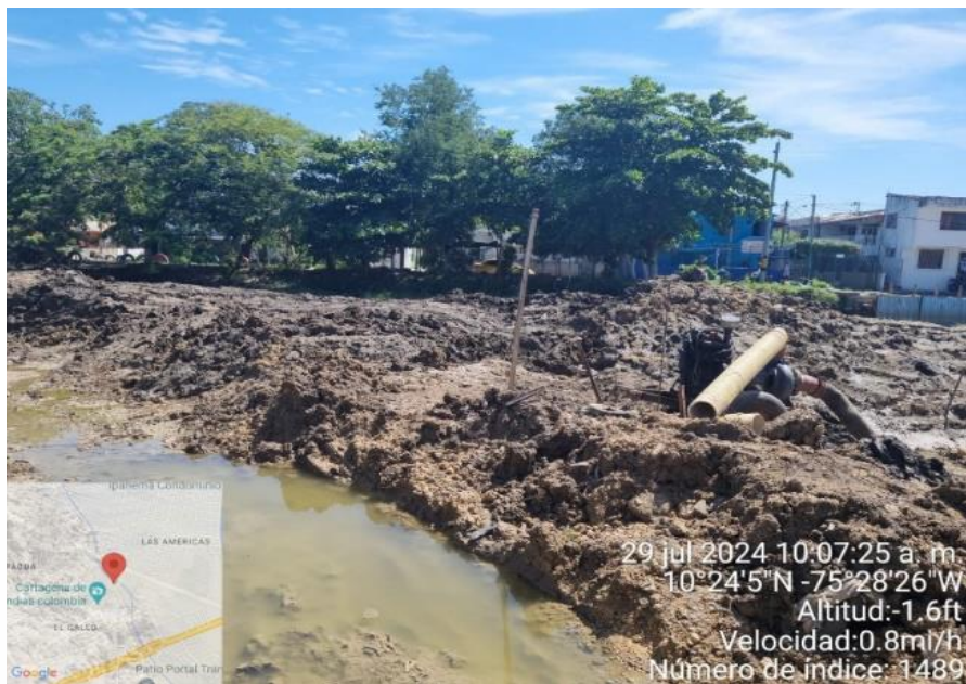
Ilustración 9. Estancamiento de aguas en el sitio de obra.
