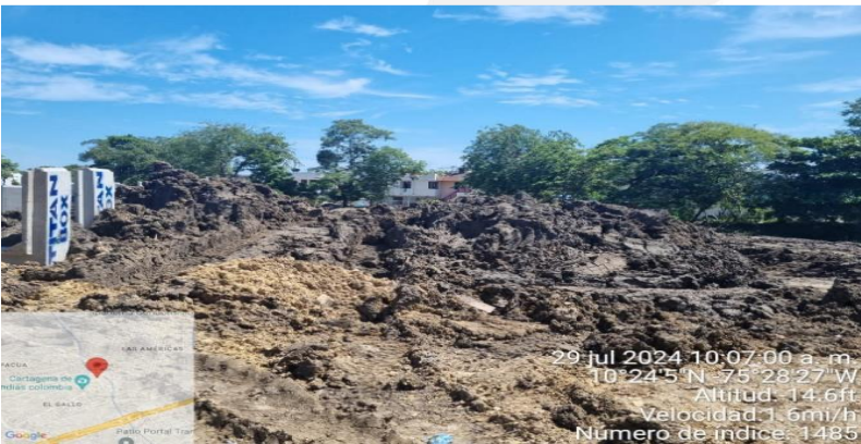
Ilustración 8. Inadecuado almacenamiento de RCD.
