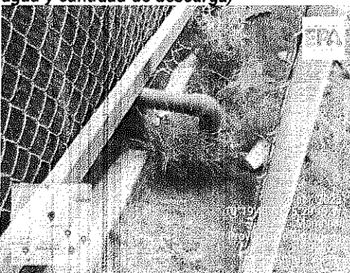
(e) Tubería que conduce las Aguas Residuales al registro
