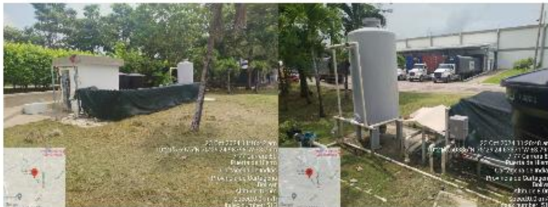
Figura. Planta de Tratamiento de Aguas Residuales Domésticas
