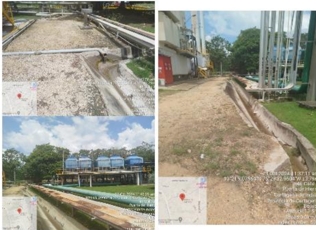
Figura. Descarga de aguas residuales no doméstica en canal abierto el cual conecta con el reservorio.
