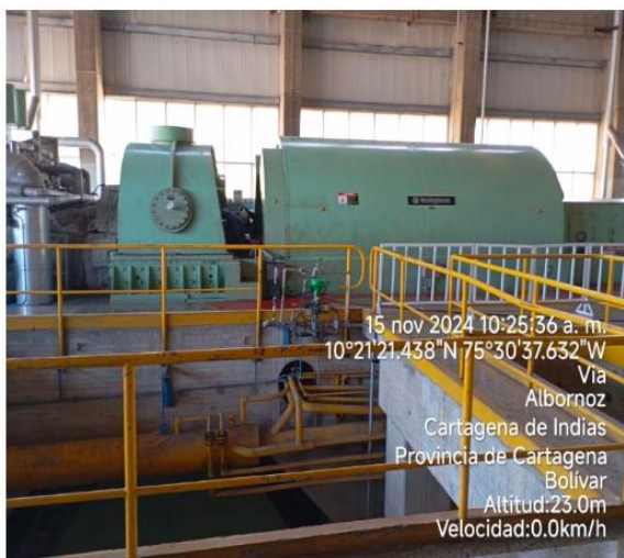
Caldera Unidad I
