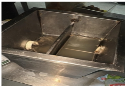
Figura 2: Trampa de Grasas Fuente: Propia
