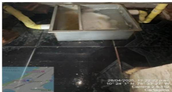
Figura 2: Trampa de Grasas Fuente: Propia
