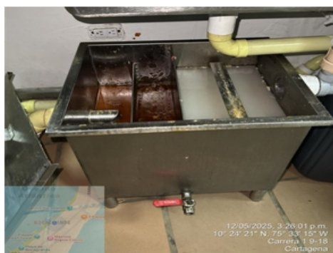
Figura 2: Trampa de Grasas Fuente: Propia
