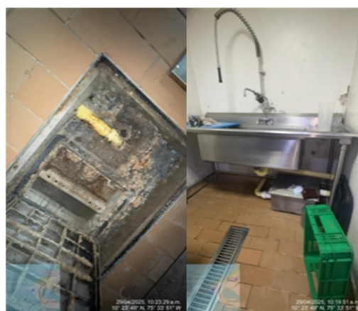
Figura 2: Trampa de Grasas Fuente: Propia
