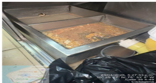
Figura 2: Trampa de Grasas Fuente: Propia
