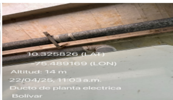
Figura 10. ducto de evacuación.
