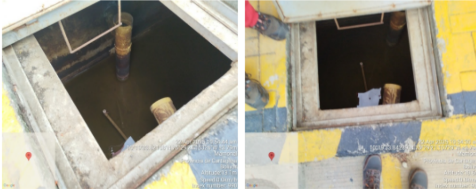
Figura 3. Estructura de almacenamiento de las ARnD
