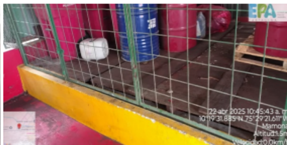
Figura 6. Dique de contención y enmallado de la zona.
