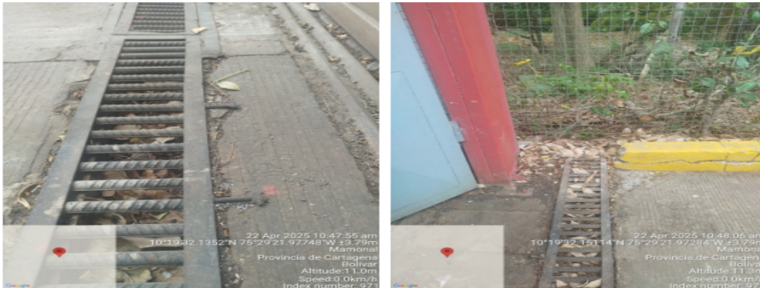
Figura 4. Canal de drenaje de aguas lluvias perimetral al centro de acopio de residuos sólidos.
