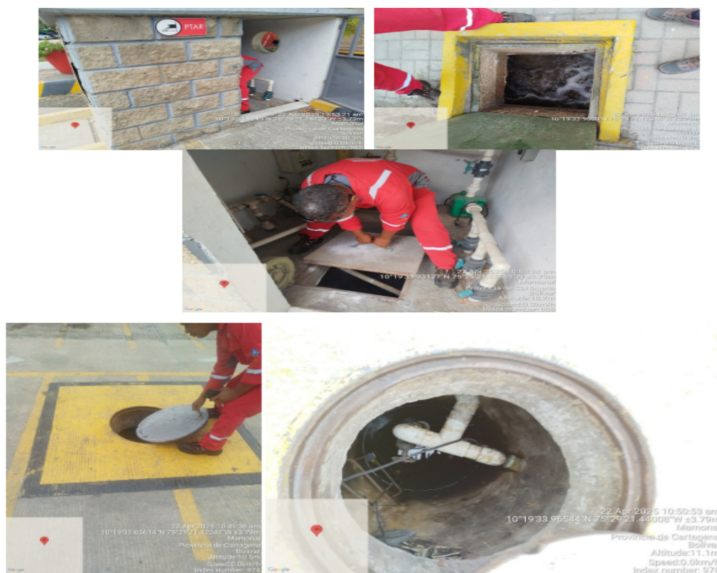
Figura 2. Registro de entrega. Se observa que el tubo proveniente de la PTARD se encuentra sellado.
