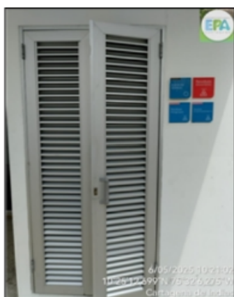
foto 3. Cuarto de almacenamiento temporal RESPEL.
