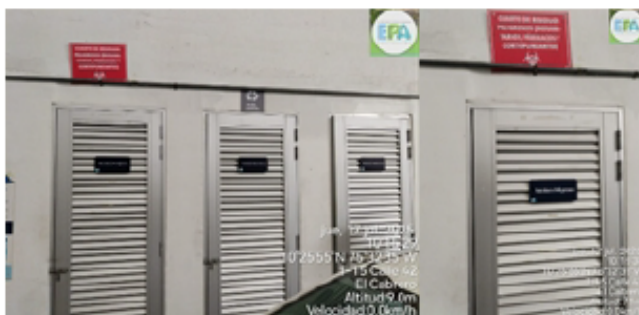
foto 4. Puerta rotulada de Almacenamiento interno RESPEL
