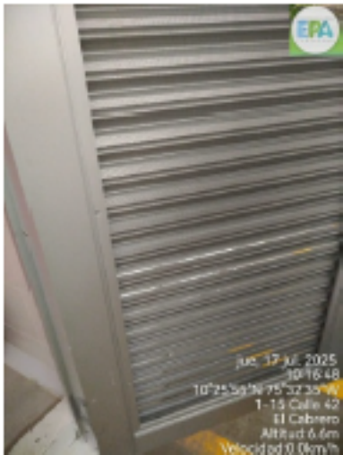
foto 10. Malla metálica para evitar ingreso de vectores
