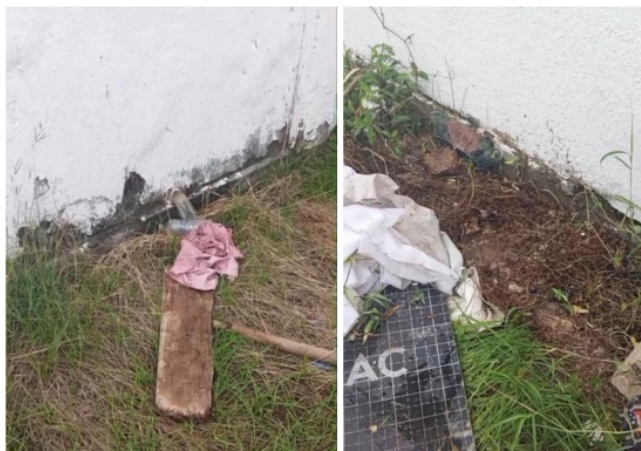
Figure 3. Evidencia de vertimiento proveniente del edificio Ana Elena hacia el lote de la cancha. Fuente: Usuario que radico la queja
