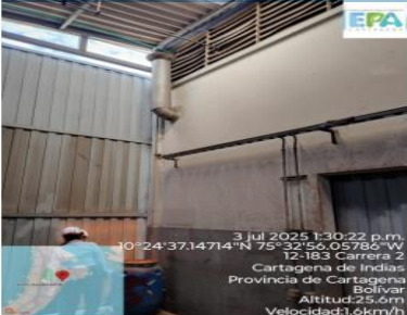
Figura: Ducto De Salida De La Máquina De Lavado De Motores
