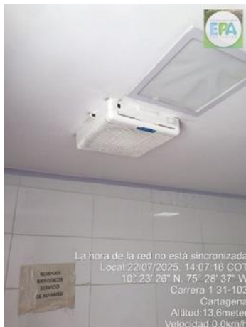
Foto 9. Extractor de aire.
