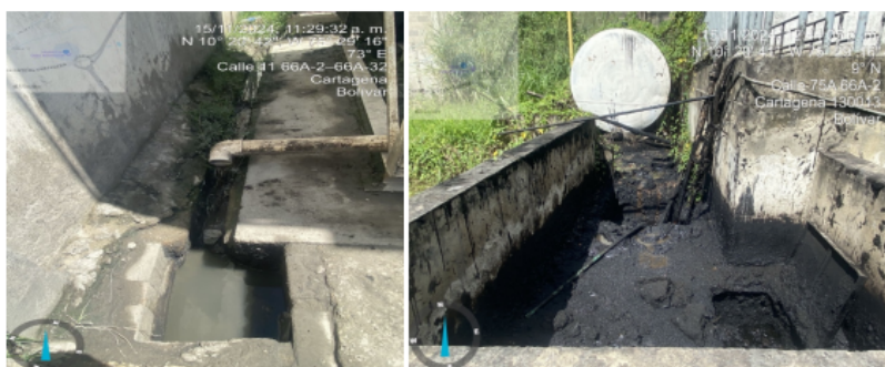
Figura 4. Tubería de purga desde el sistema de control al canal de desagües.
