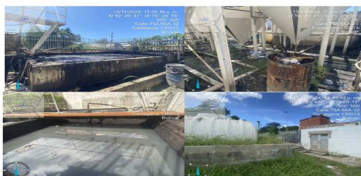
Figura 3. Sistema de tratamiento de aguas residuales.
