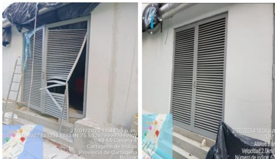
Registro fotográfico de la puerta averiada arreglada.
